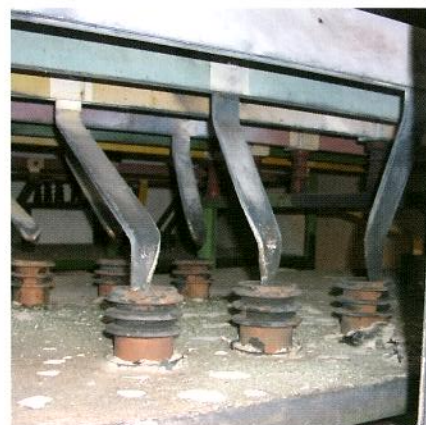
Uničeni izolatorji in zbiralke
