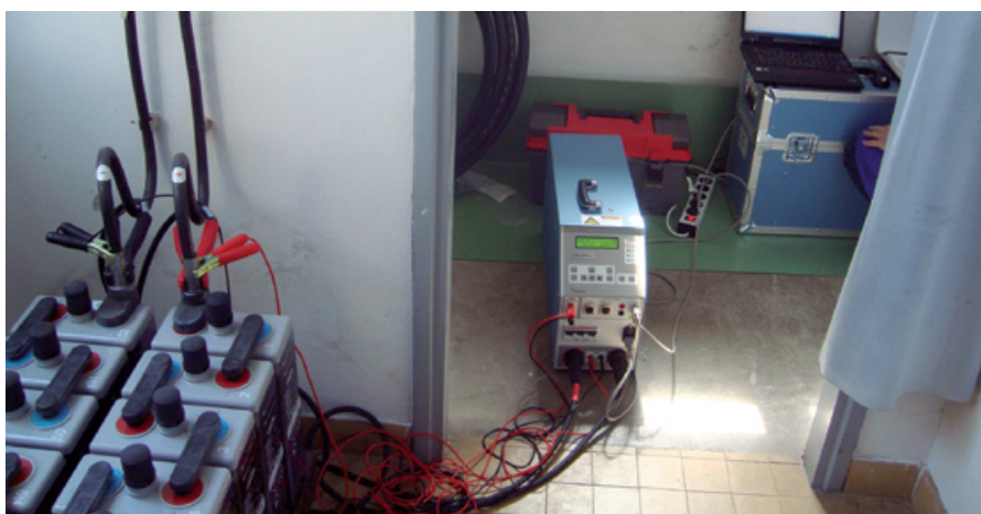
Natančna kontrola akumulatorskih baterij
