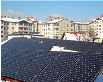
Slika 2: Nadgradnja sončne elektrarne EGRM v Radvanju je bila priključena na distribucijsko omrežje 22. 12. 2008
