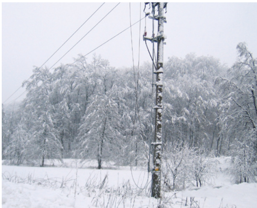
Pretrgani vodniki na 20-kV daljnovodu
