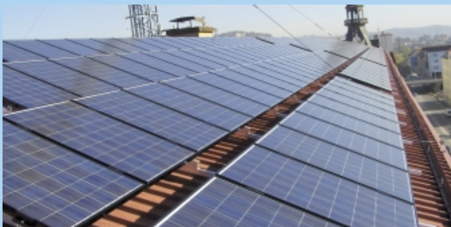
Fotonapetostni moduli na stavbi Elektra Maribor
