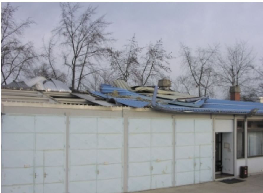
Veter je uničil streho na ljutomerskih objektih.
