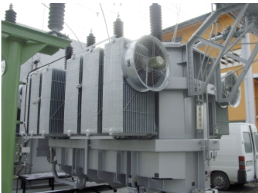
Energetski transformator v RTP Murska Sobota
