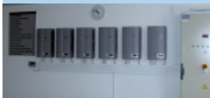
Razsmerniki in električna razdelilna omara v četrtem nadstropju poslovne stavbe Elektra Maribor.
